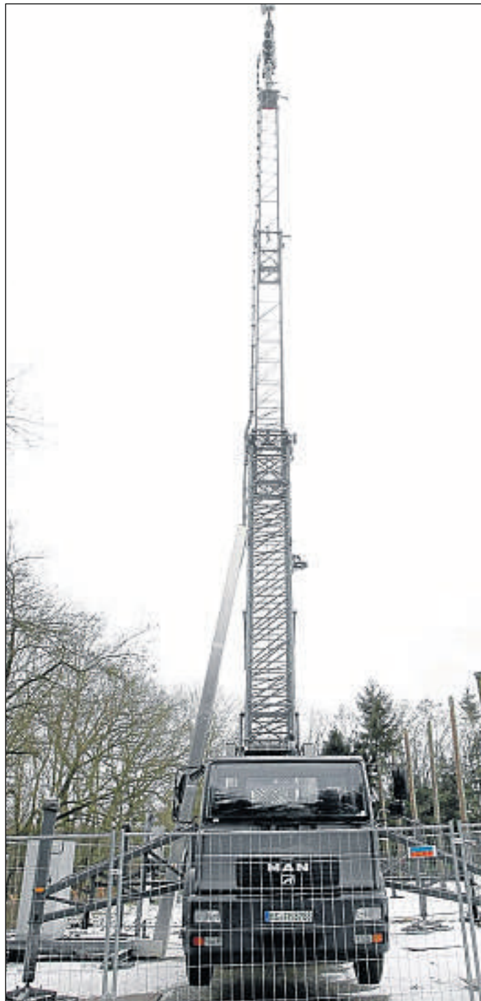
Schnelle Verbindung: Der mobile Funkmast auf dem Bührener Sportplatz wird spätestens im Sommer durch eine feste Anlage ersetzt.
